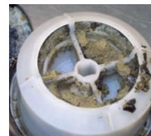
Zentrifugentrommel, durch Schlamm in der Leistung beeinträchtigt
